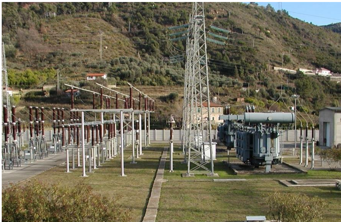
Figura 1.4: Esempio di sottostazione di trasformazione
