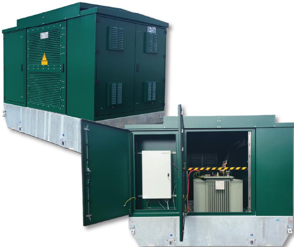
Figura 35 – Vista laterale cabina di trasformazione FEAG
