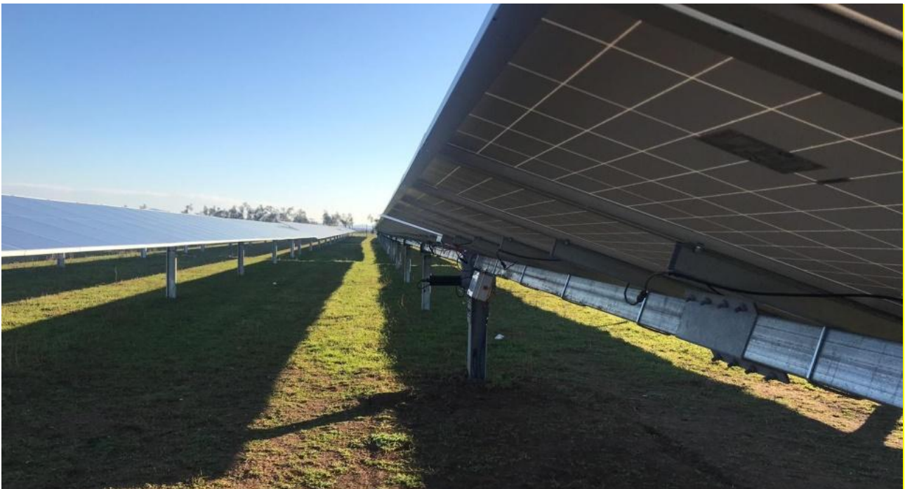
Figura 43 - Inseguitore monoassiale vista laterale
