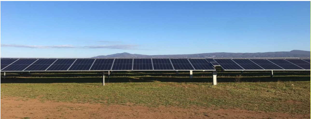
Figura 42 - Inseguitore monoassiale vista frontale
