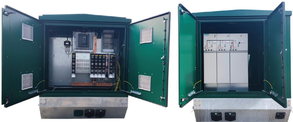
Figura 36 – Viste anteriore e posteriore cabina di trasformazione FEAG
