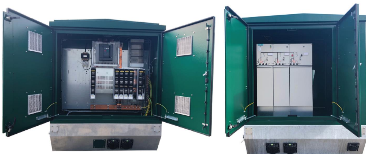
Figura 36 – Viste anteriore e posteriore cabina di trasformazione FEAG
