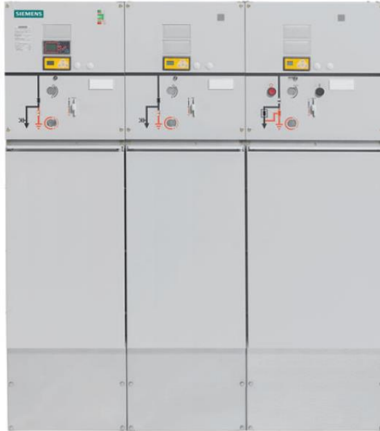
Figura 37 – Vista frontale quadro di protezione in media tensione della cabina di trasformazione
