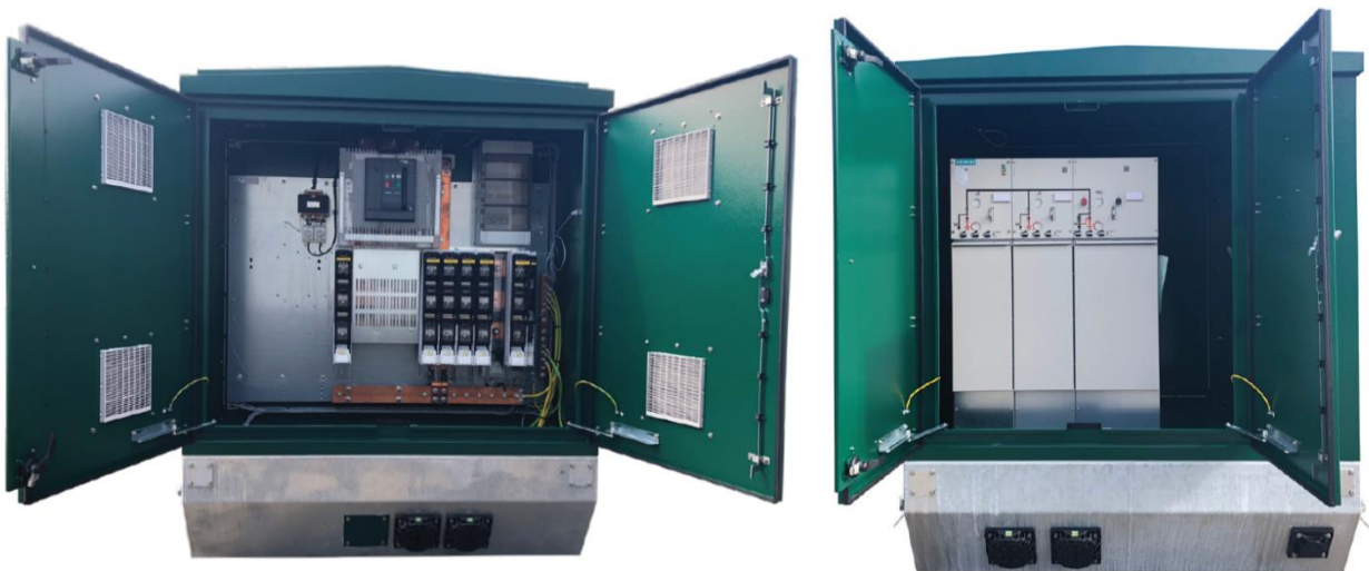
Figura 7 - Cabina elettrica di trasformazione – viste frontali
