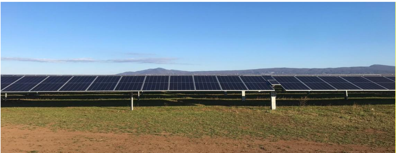
Figura 21 - Inseguitore monoassiale vista frontale
