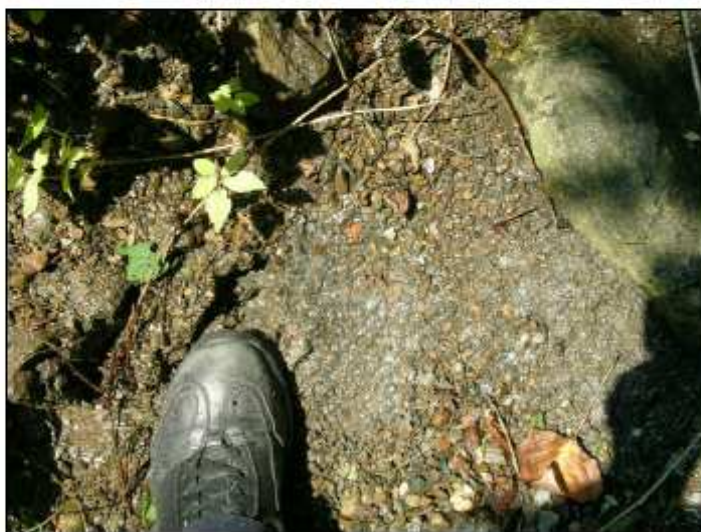
Foto n.6: in diversi punti alla base del versante la copertura superficiale "trasuda" acqua
