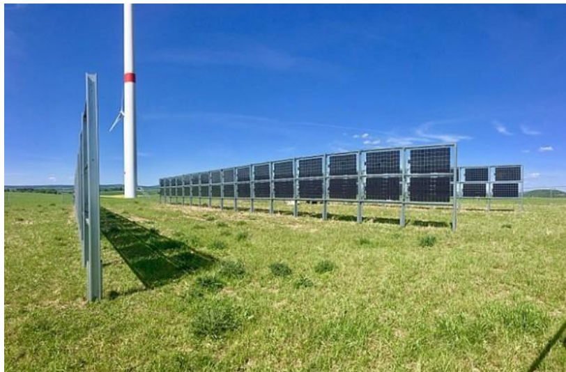
Figura 56: Esempio di Agrovoltaiico con pannelli bifacciali installati in verticale
