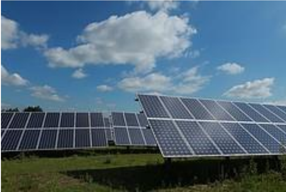
Figura 4: Esempio di impianto realizzato al suolo, fisso, con pannelli in configurazione bifilare
