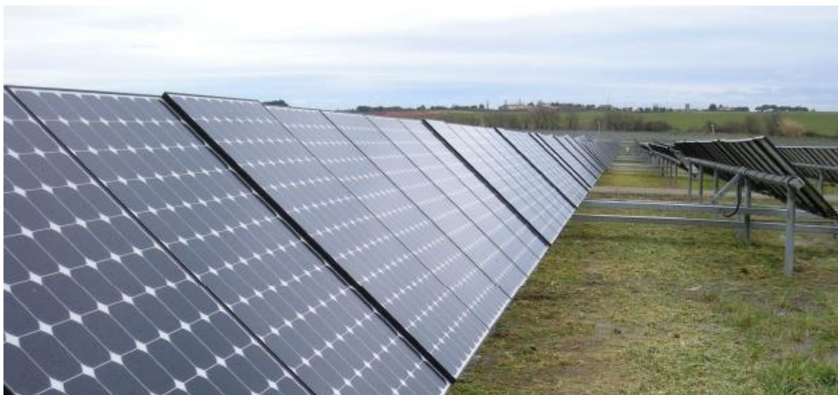
Figura 99 - Stato del terreno inerbito sotto i pannelli fotovoltaici
