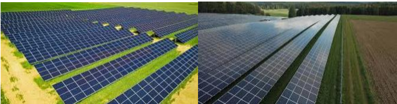
Figura 26- Campi fotovoltaici con 4 pannelli orizzontali
