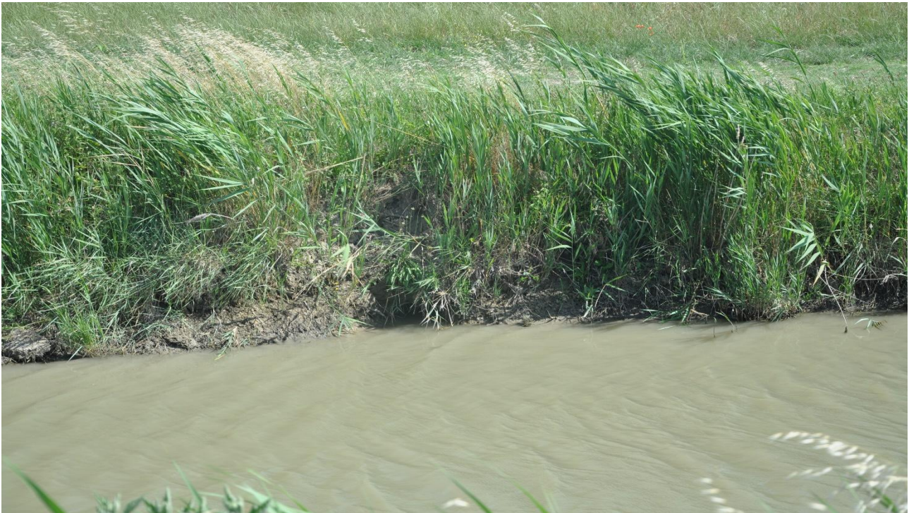
Figura 73 – Gallerie scavate dalle Nutrie sulle sponde dei canali
