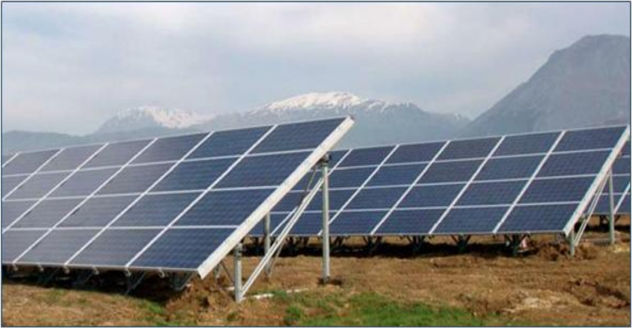
Figura 25 – Impianto con strutture fisse
