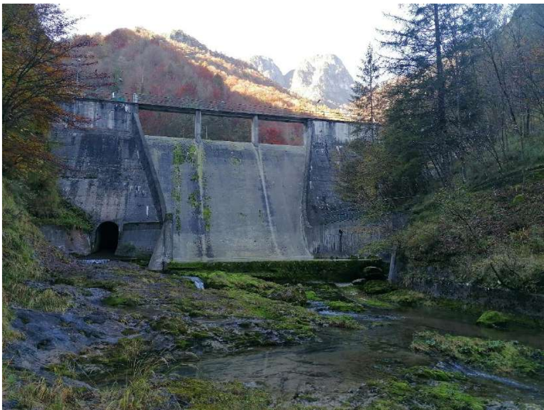
Foto 1 vista della diga di Cassiglio: costruita nel 1951-1952 necessita ora di interventi di adeguamento statico e idraulico
