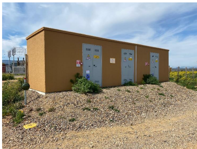
Immagine 1.7: tipologia cabina inverter
