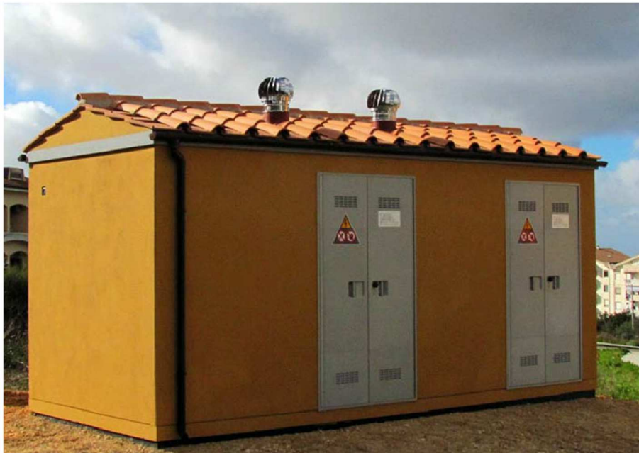
Figura 4. Tipico di cabina elettrica di trasformazione.
