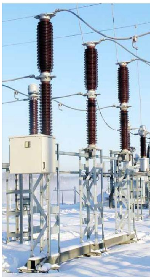
Figura 9.13. Particolare Interruttore con TA incorporato.
