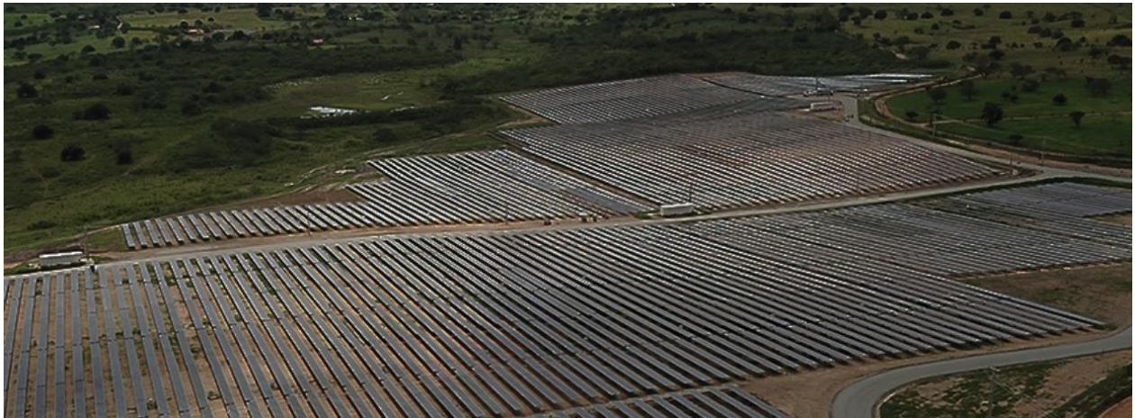
Figura 3.8: Esempio di Impianto realizzato con Tracker Monoassiale
