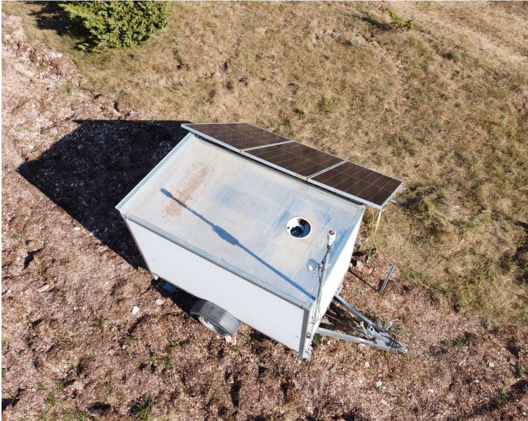
Figura 3: LIDAR completo di sistema di alimentazione, contenimento/protezione e sorveglianza; si noti che il LIDAR vero e proprio si trova all'interno della struttura mostrata in figura in modo da essere protetto dagli agenti atmosferici, manomissioni, animali ecc.
