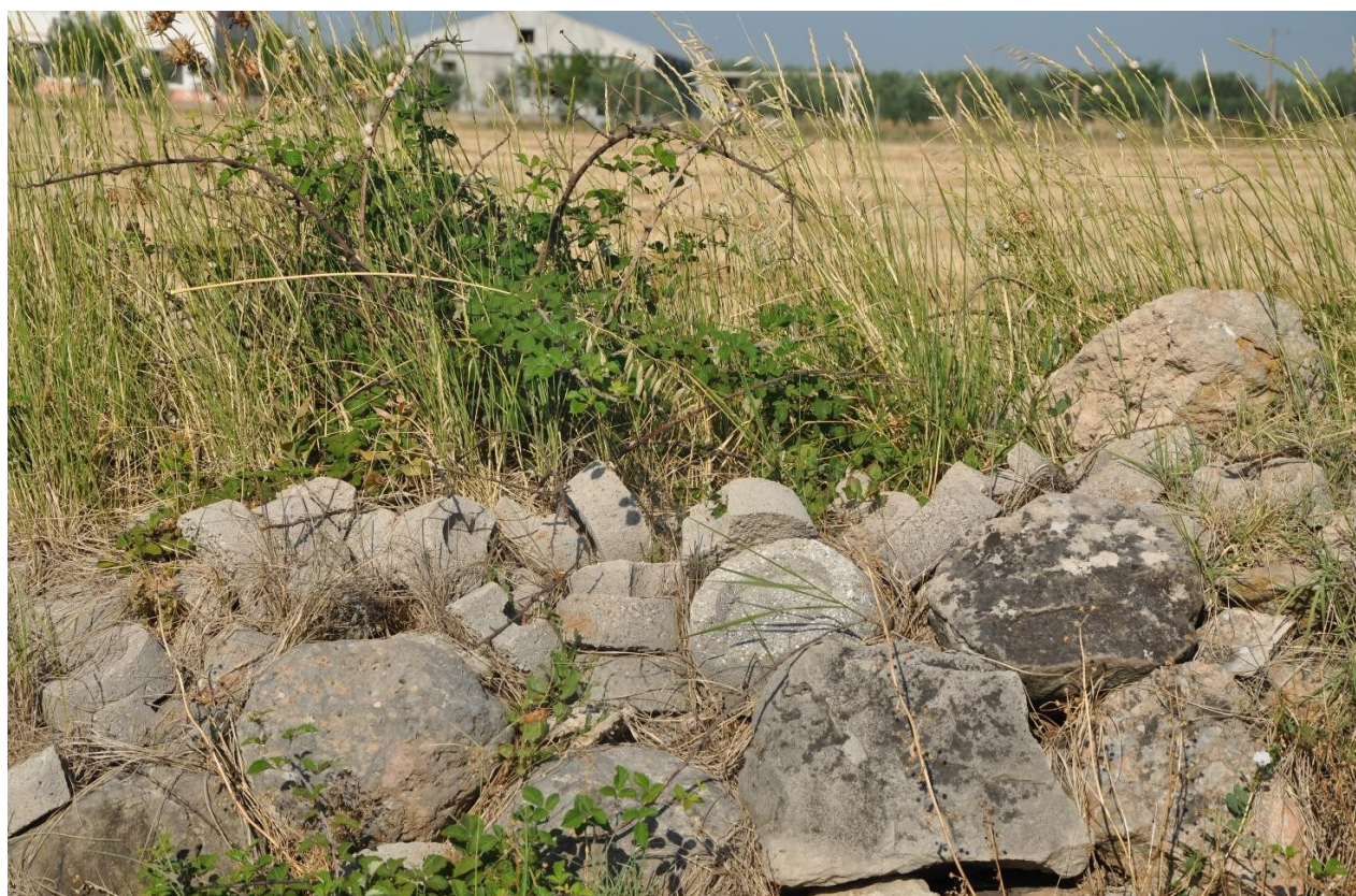
Figura 61 - Muretto deformato e degradato dall'abbandono delle basi dei paletti in cemento di un vigneto
