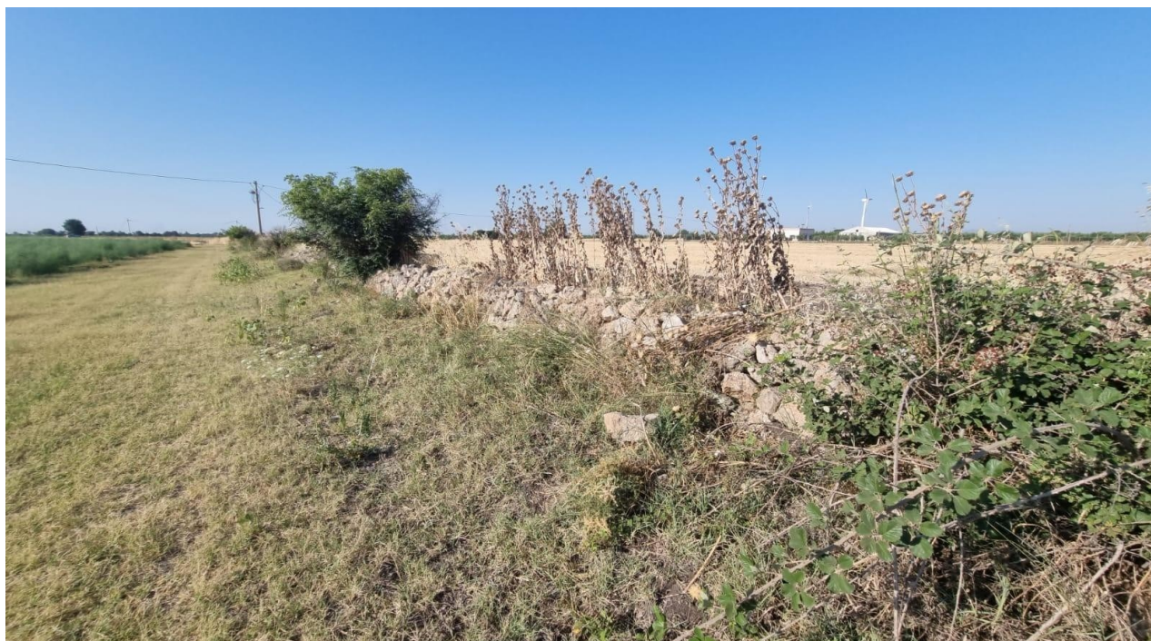
Figura 60 - Muretto a secco deformato che delimita la proprietà
