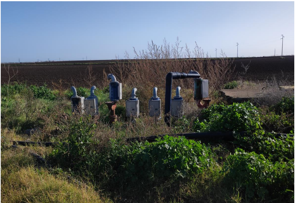
Impianto irriguo aziendale - gruppo elettropompa filtro
