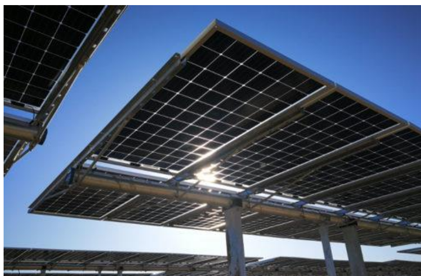
Figura 2.16 Esempio di struttura a tracker monoassiale
