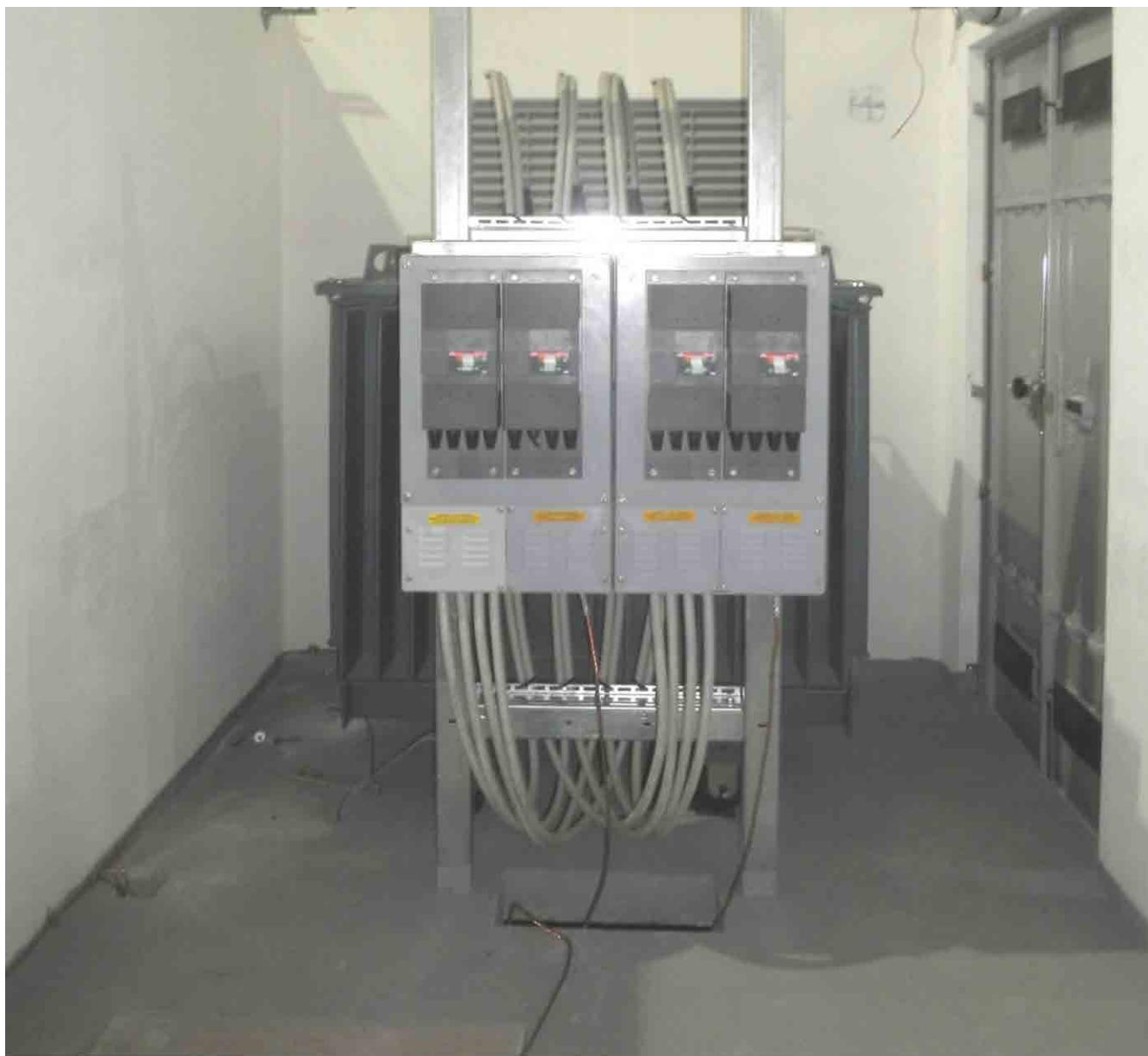
Esempio quadro BT installato
