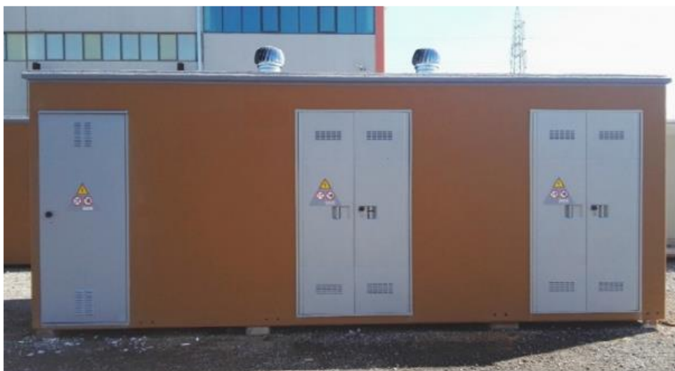
Figura 18: pianta e foto della stazione di campo (power station).
