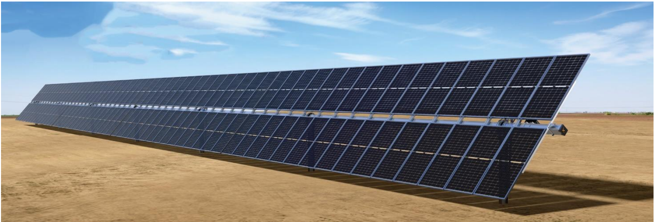
Figura 16: trackers tipo con pannelli installati.
