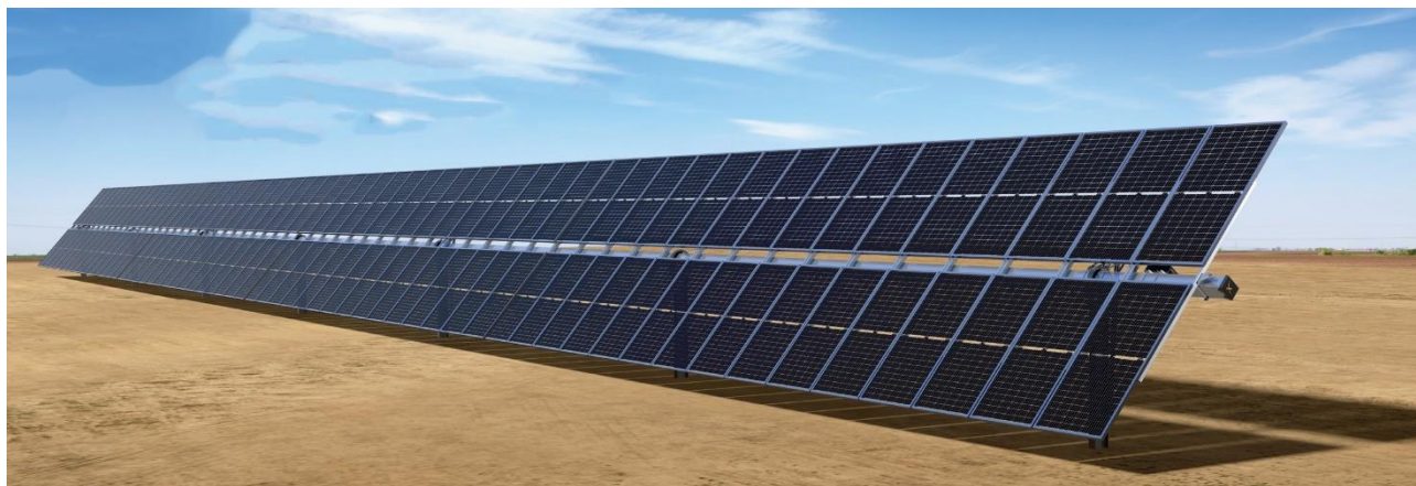
Figura 15: trackers tipo con pannelli installati.
