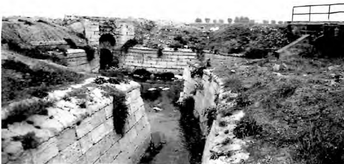
Canale maestro e allacciante sinistro della Salina Grande di Taranto, entrambi confluenti nella galleria sotterranea. (foto Antonio Vincenzo Greco)
