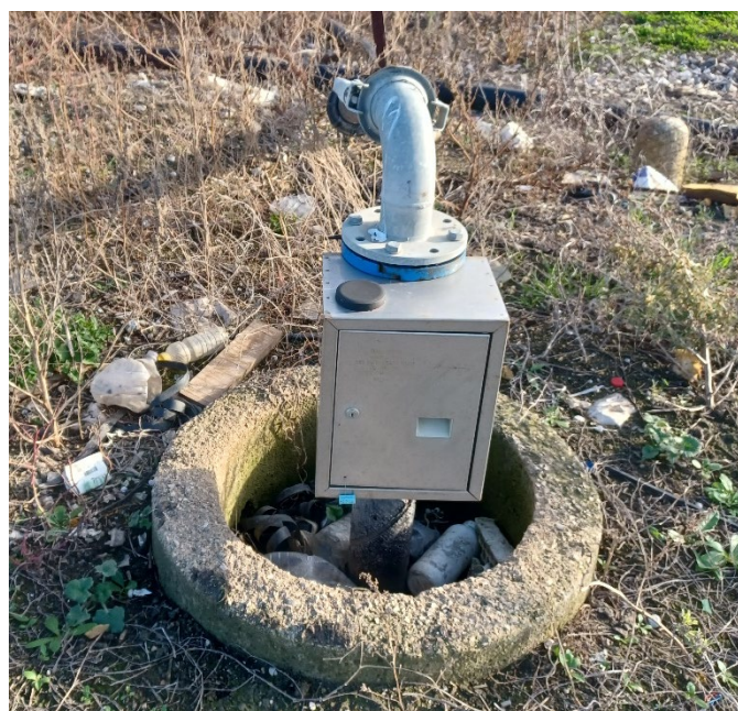
Figura 58: Foto di dettaglio su manufatto idraulico in corrispondenza del limite del Lotto 5.
