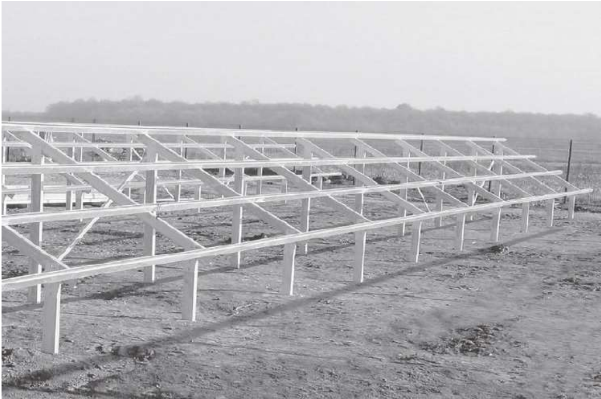
Figura 2 - Esempio struttura fissa
