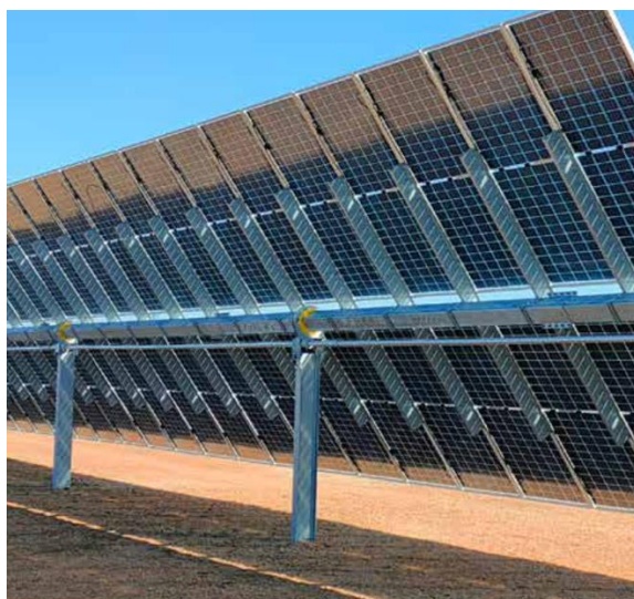
Figura 4 – Particolare Inseguitori mono assiali (Est-Ovest)
