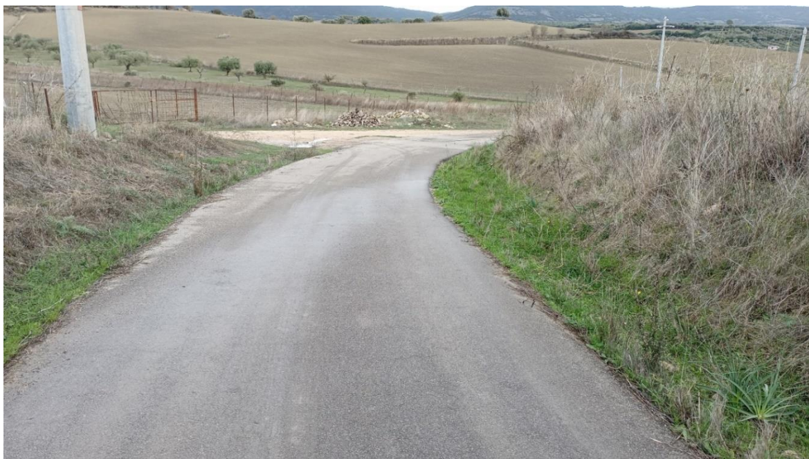
Figura 5.5 – Sulla sinistra punto di innesto tra il primo tratto di viabilità da adeguare e quello di nuova realizzazione che si dirama in direzione ovest
