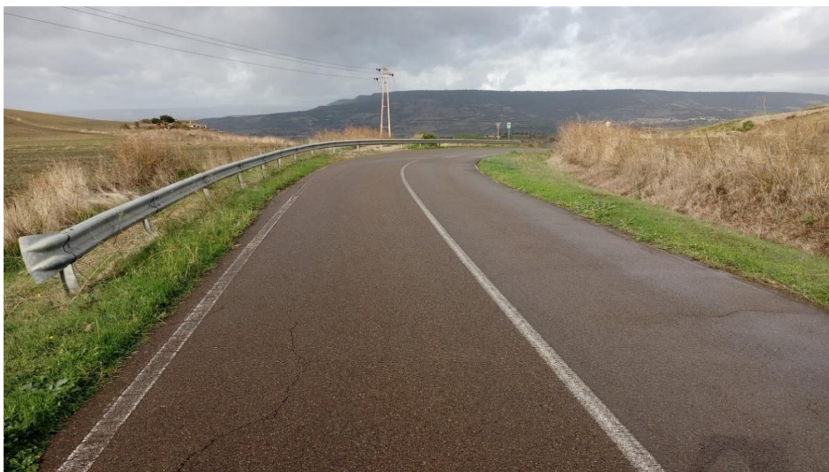
Figura 5.2 – Tratto stradale della SP9 con veduta verso il punto di inizio della viabilità da adeguare di accesso alla WTG01
