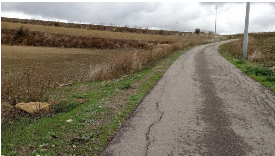
Figura 5.13 – Tratto di viabilità da adeguare lungo la Strada Comunale Gergei Villanovafranca in direzione est. A sinistra si innesterà il tratto di viabilità di nuova realizzazione che si sviluppa in direzione nord
