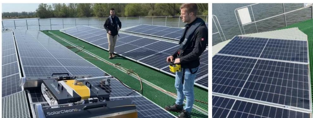
Figura 14: Manutenzione pannelli solari tramite robot (immagine di Solar Duck)
