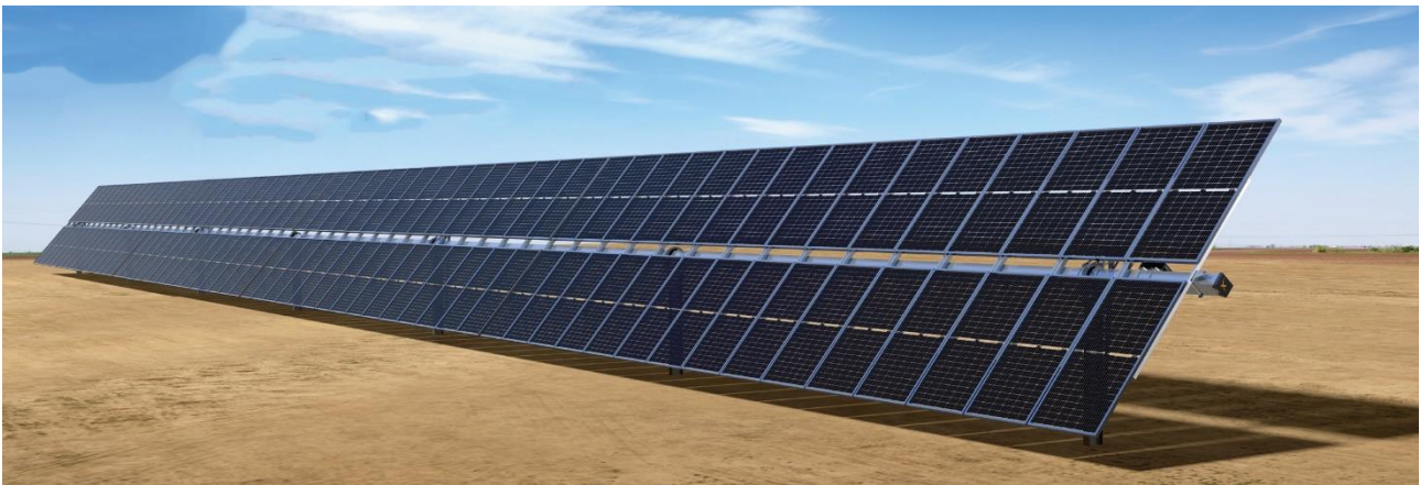
Figura 15: trackers tipo con pannelli installati.
