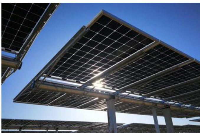
Figura 2.3: Particolare strutture di sostegno moduli
