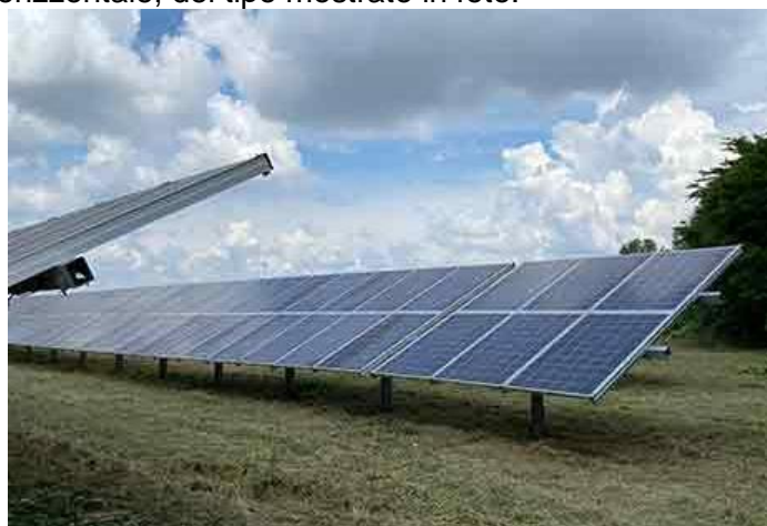
Figura 2.5: Particolare strutture di sostegno moduli
