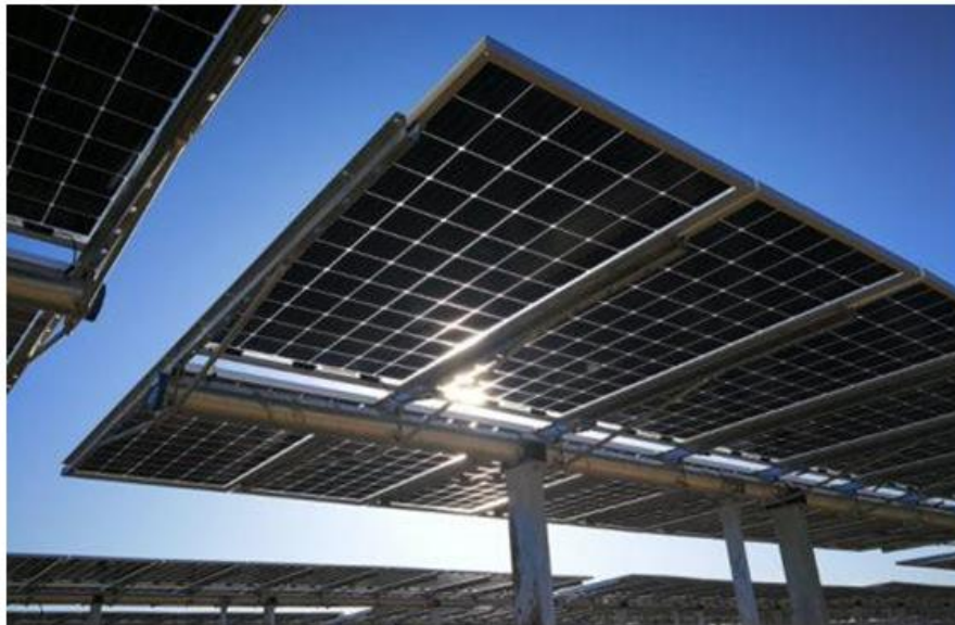
Figura 3.6: Particolare strutture tipo trackers di sostegno moduli
