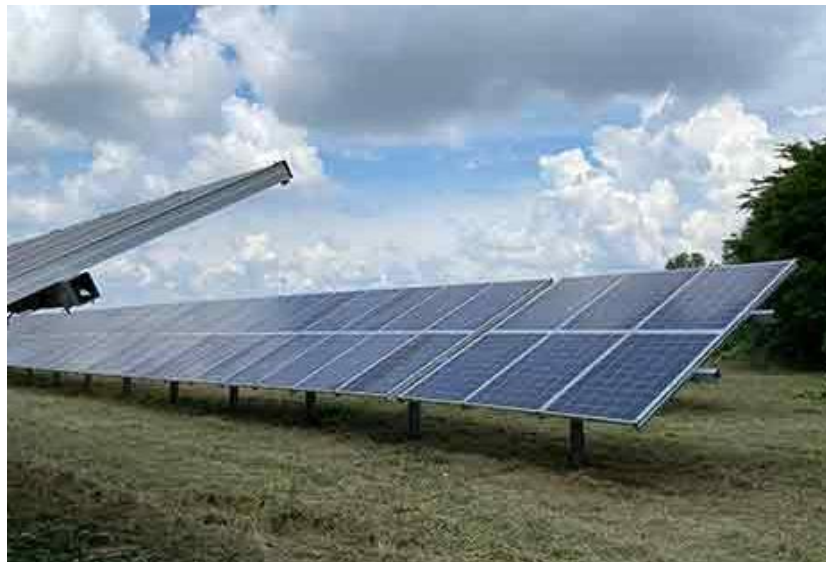
Figura 3.7: Particolare strutture tipo fisse di sostegno moduli
