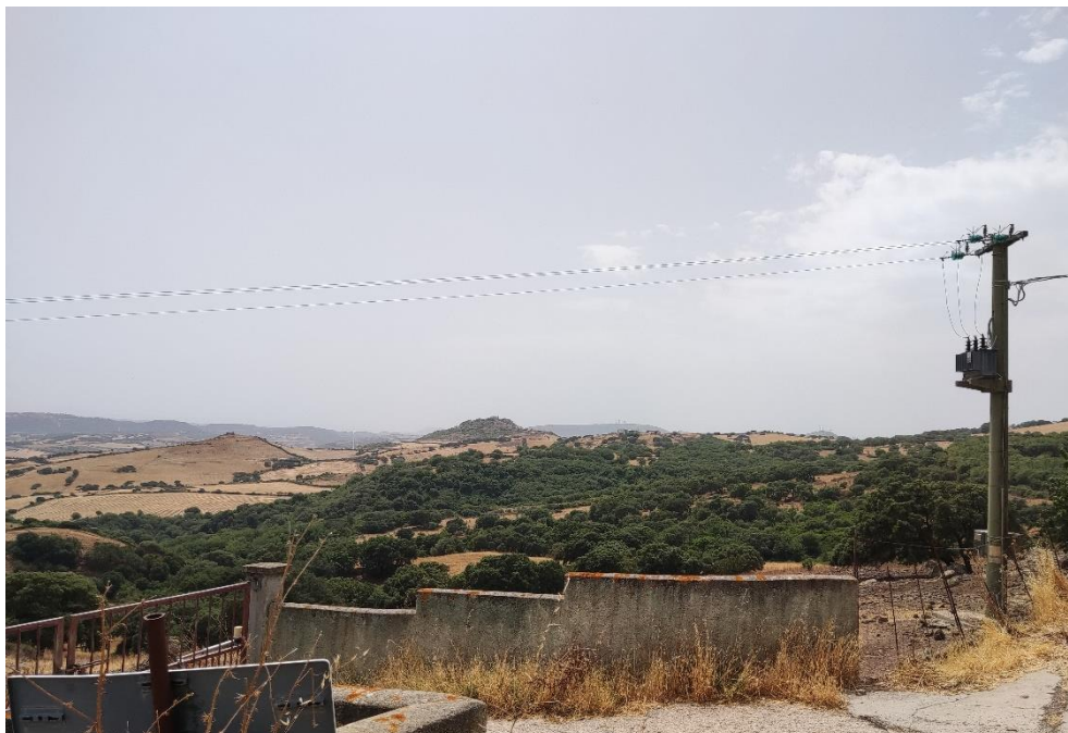
Figura 2.2: Linea aerea di media tensione MT_A01 (40.81283100, 8.78062100).
