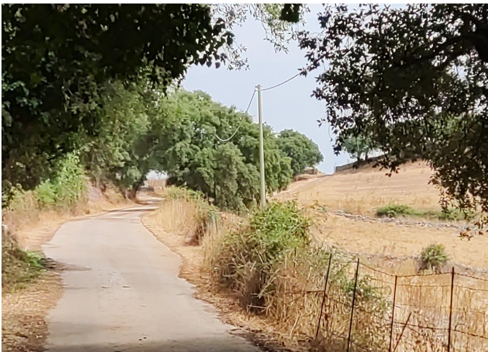
Figura 2.4: Linea aerea di bassa tensione BT_A02 (40.81508900, 8.78253800).
