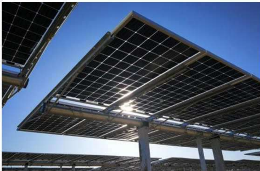
Figura 3.2: Particolare strutture tipo trackers di sostegno moduli
