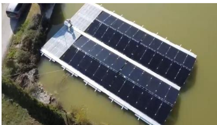
Figura 5.3 – Esempio di pannelli fotovoltaici su piattaforma galleggianti
