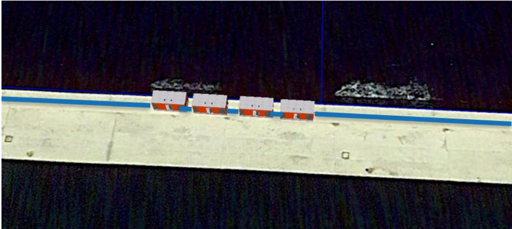
Figura 1-7: Cabinati per trasformatori BT/MT su banchina
