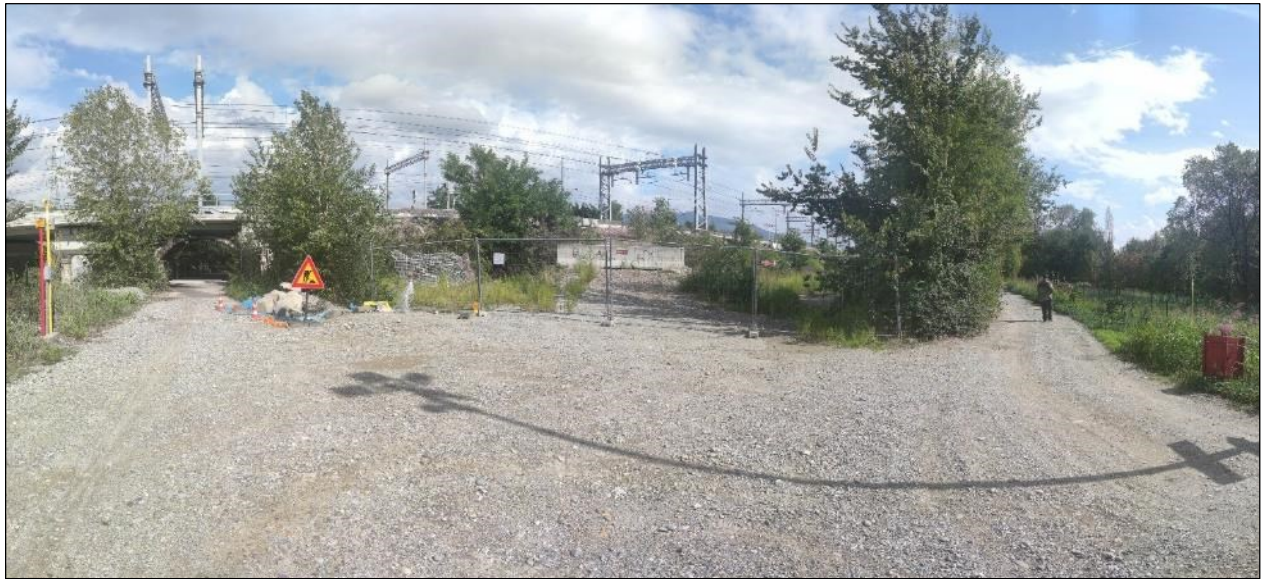
Stazione VEG01 – Panoramica dell'area di cantiere. Si può osservare la ripresa vegetativa di specie arboreo-arbustive (al centro) e le ripiantumazioni di recente impianto (a destra).
