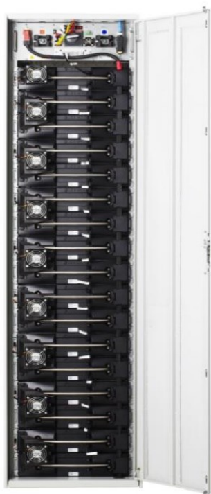
Fig. 34 - Esempio rack batterie
