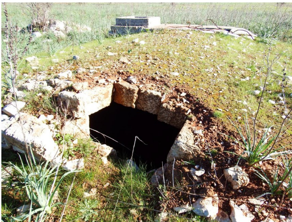
Fig. 27 – Cisterna raccolta acque piovane interrata presente nei pressi di Masseria S. Elmi
