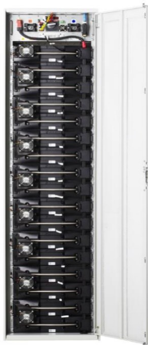
Fig. 23- Esempio rack batterie
