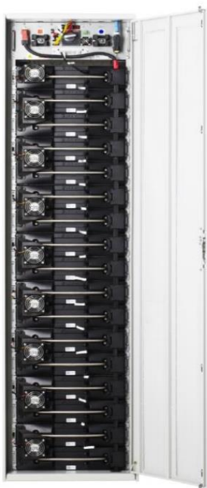
Fig. 58 - Esempio rack batterie
