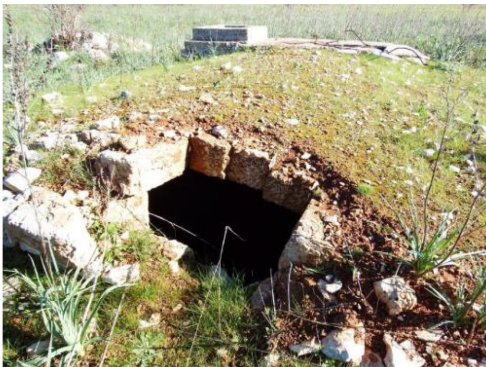
Fig. 51 – Cisterna raccolta acque piovane interrata presente nei pressi di Masseria S. Elmi
