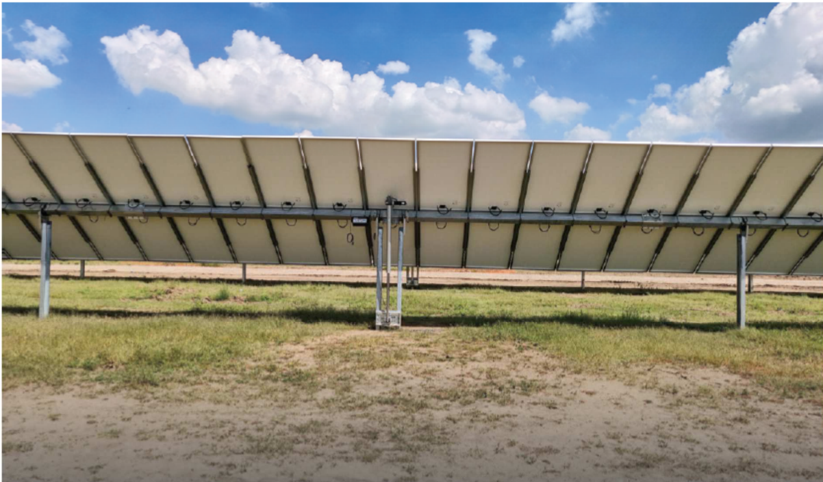
Figura 15 Inseguitore monoassiale vista tergale
