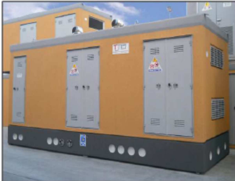
Figura 16 Cabina elettrica tipo
