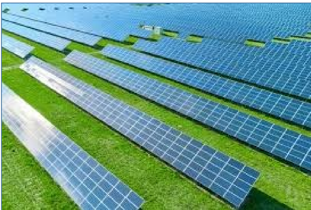
FIGURA 12: CAMPO CON 4 MODULI IN ORIZZONTALE SU STRUTTURA FISSA
