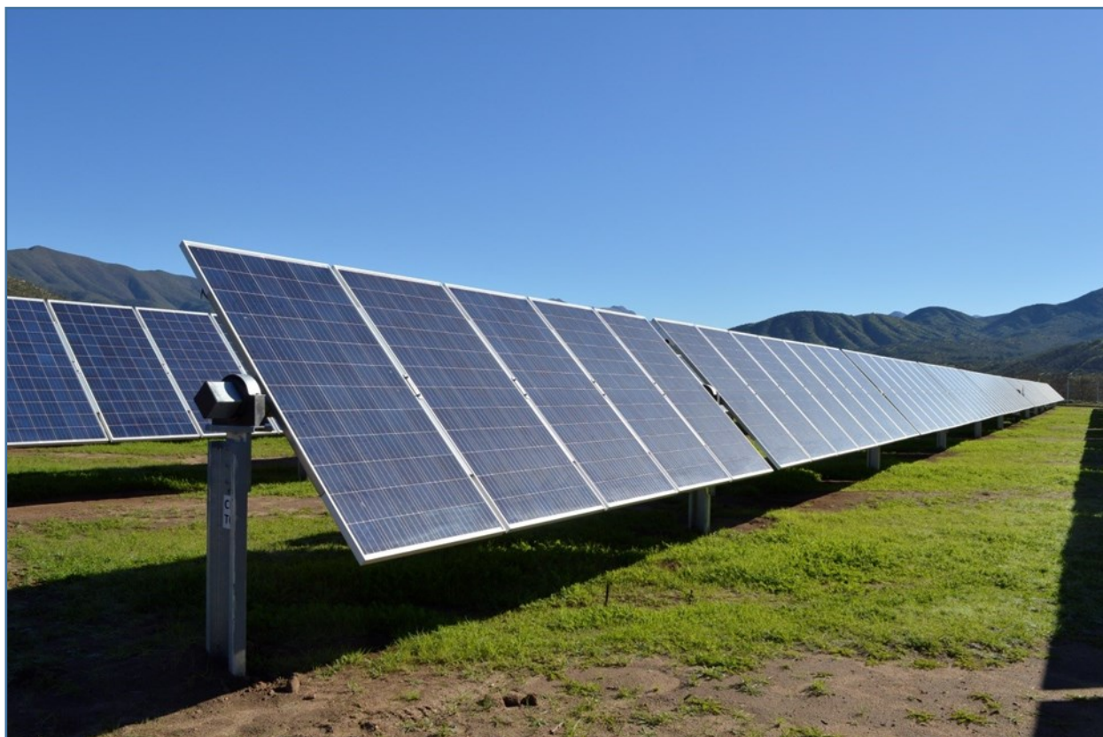
FIGURA 15 – INSTALLAZIONE SU INSEGUIDITORE MONO ASSIALE CON SINGOLO MODULO
