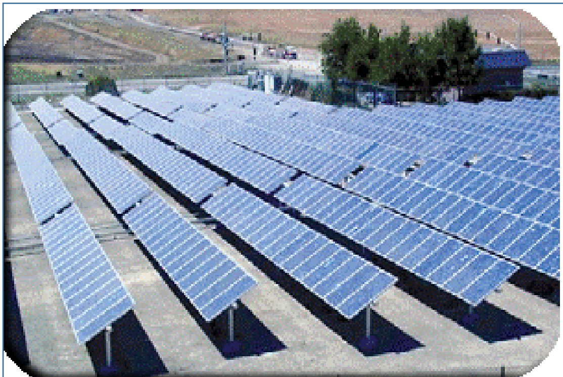
FIGURA 14: CAMPO CON SINGOLO MODULO IN VERTICALE SU INSEGUITORE
