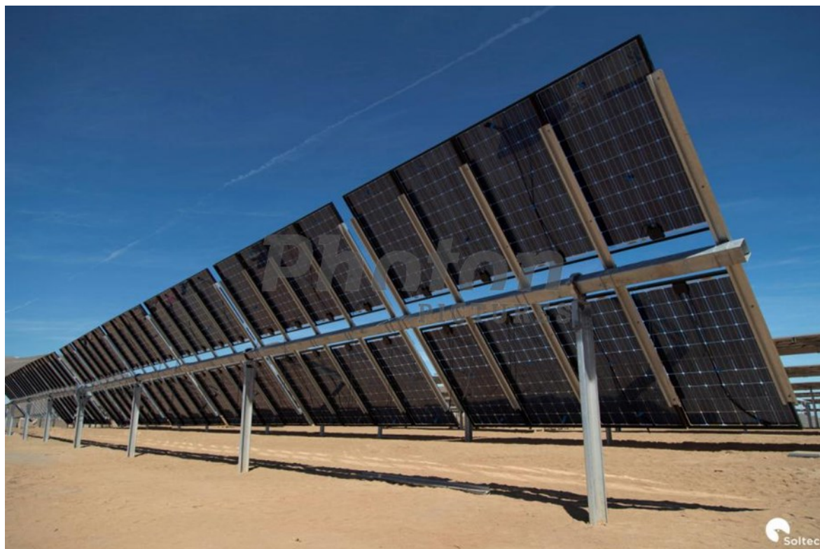
Figura 2-6: esempio campo fotovoltaico con moduli installati su inseguitore mono assiale
