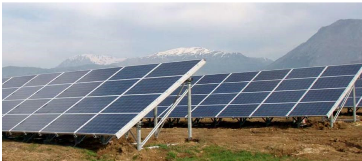
Figura 2-5: esempio campo fotovoltaico con 4 moduli in orizzontale montati su struttura fissa
