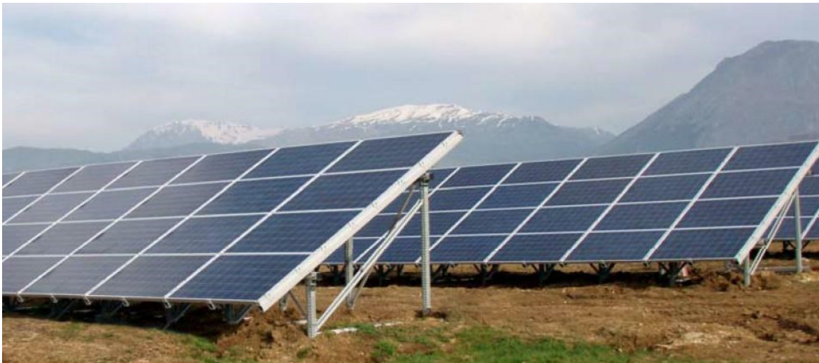
Figura 3-6: esempio campo fotovoltaico con 4 moduli in orizzontale montati su struttura fissa
