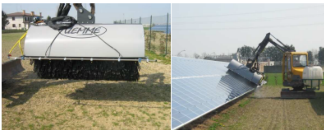
Dispositivo di pulizia moduli Fig.3.27- Pulizia dei moduli
