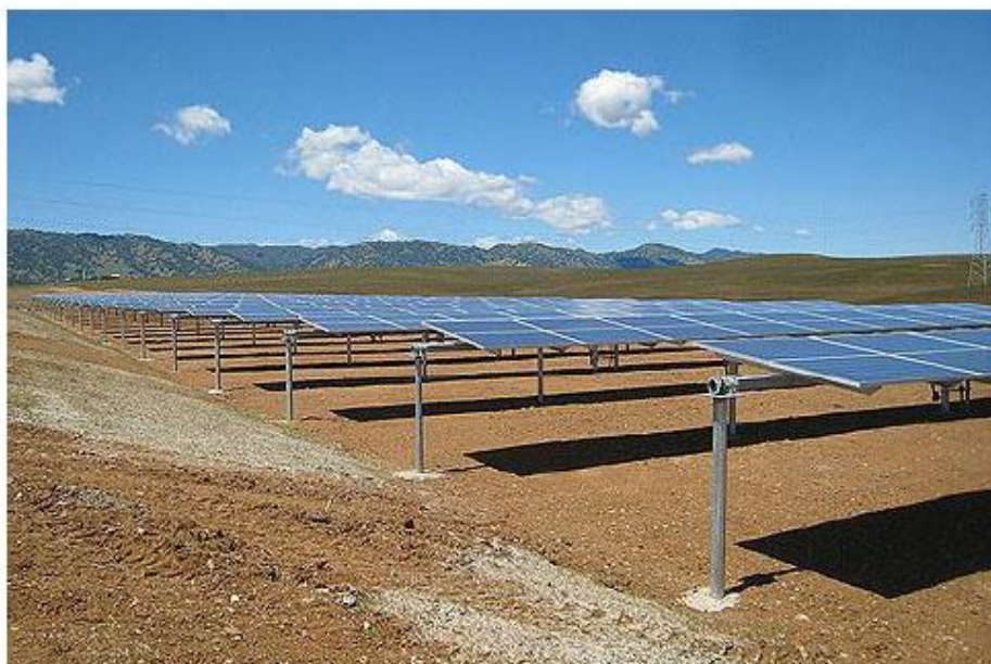
Figura 3.1-3 Inseguitori di Rollio
