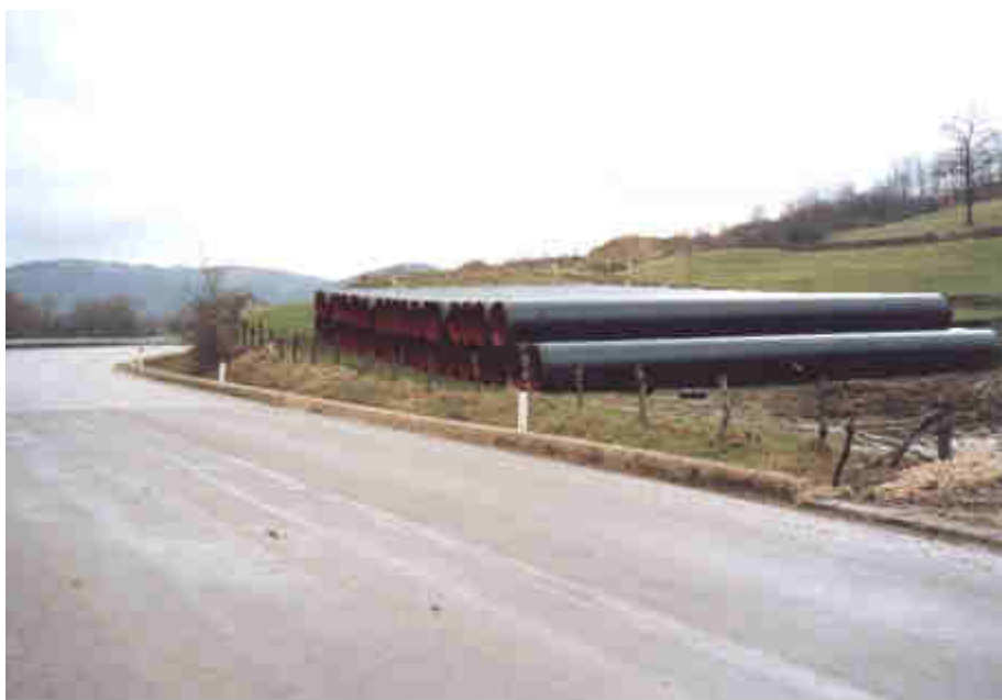
Fig. 10-2 – Esempio di piazzola per l'accatamento tubazioni lungo il cantiere di un gasdotto.
