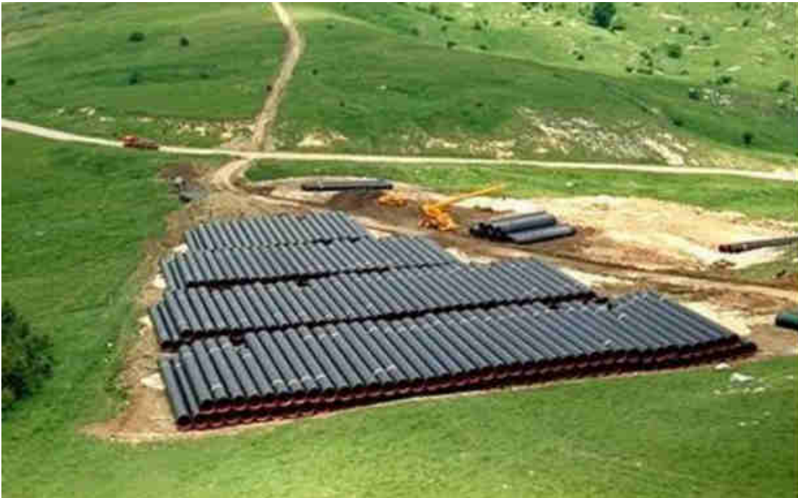
Fig. 10-3 – Esempio di piazzola per l’accatostamento tubazioni lungo il cantiere di un gasdotto.
