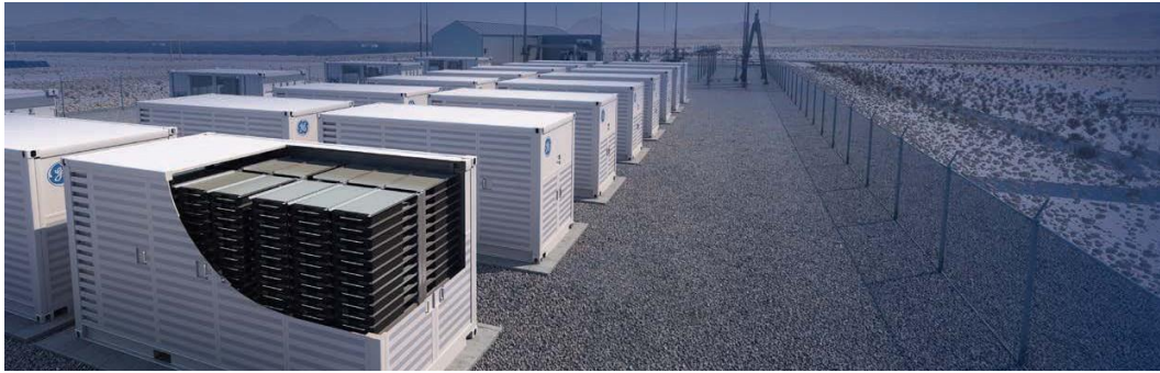
Esempio di batteria di accumulo
