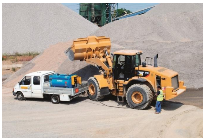
Esempio di rifornimento nell'area di cantiere: da evitare-
