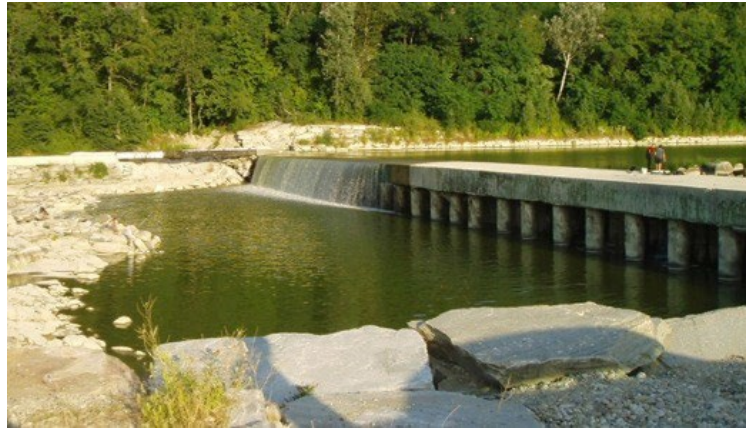
Figura 8 - Traversa realizzata nel 2002, definitivamente crollata nel 2010.
