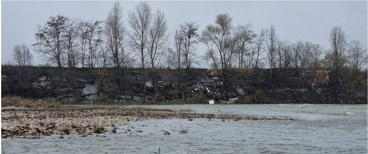
Figura 30 – Difese spondali localizzate in battuta in corrispondenza del meandro in elevato grado di dissesto ed instabilità. Si prevede il ripristino e la ricostruzione della scogliera abbattuta con la formazione di una nuova scogliera per un'estensione di 260 m
