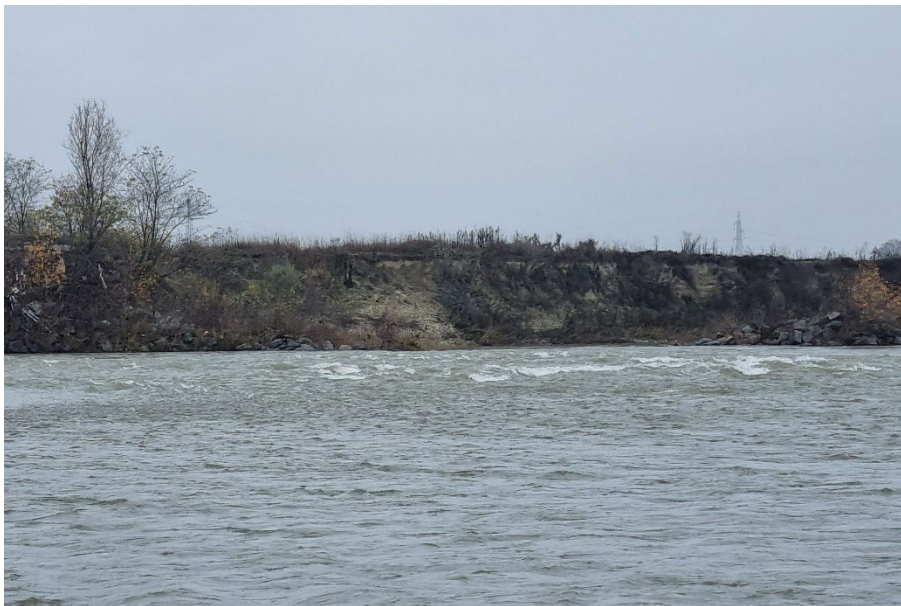
Figura 35 – Fenomeni di erosione accentuata in corrispondenza della battuta di sponda
