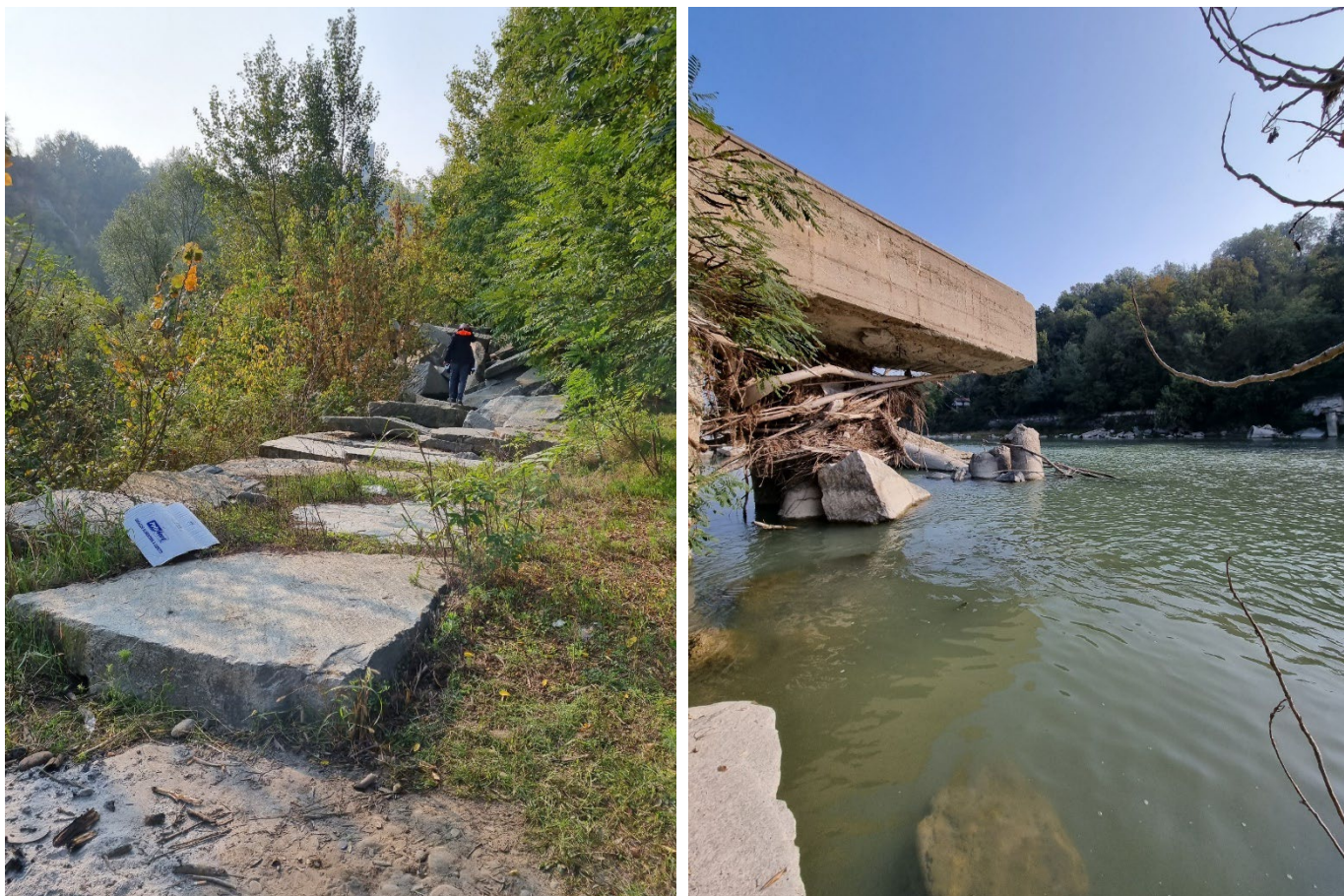
Foto 3 – porzioni del relitto dalla preesistente traversa in c.a.
