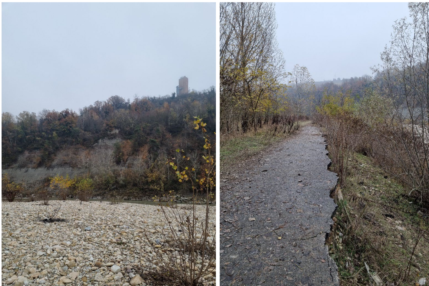
Foto 6 – Scarpata verso la torre di Barbaresco e viabilità di accesso danneggiata.
