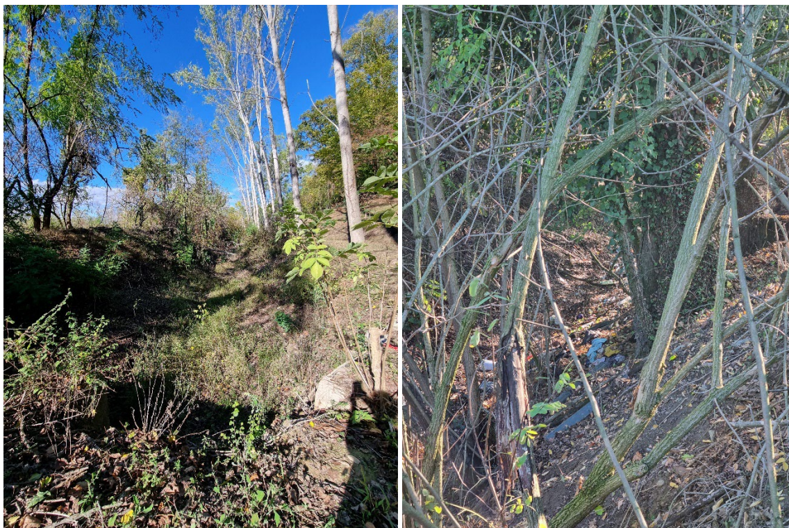
Figura 15 – Canale irriguo in terra a cielo aperto nel tratto a valle dell'edificio di guardiania fino alla SP3. Si nota come attualmente il canale sia impropriamente utilizzato per lo scarico dei rifiuti
