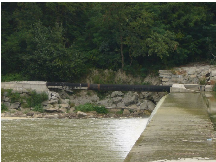
Figura 9 – Soglia di sfioro della traversa e opera di presa del canale irriguo con primo tratto intubato, nel periodo 2004-2010 in seguito allo scalzamento della scogliera in destra ed il crollo del tratto iniziale del canale irriguo sostituito quindi con un ponte-canale.
