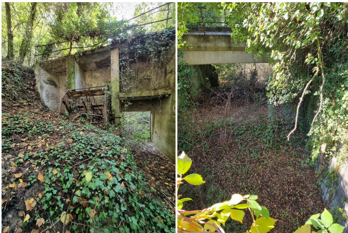
Figura 13 – Manufatto di passaggio (sx) e scaricatore per la restituzione delle acque nel Tanaro (dx)
